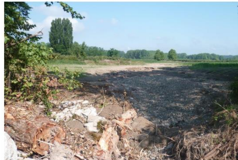
Figure 17 : Toumbe – érosions en rive droite – 11/07/2018
