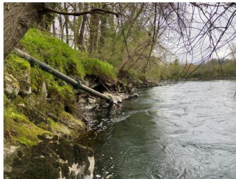
Figure 11 : Exemple d'envochements sous-cavés - pk 4,75 - rive gauche
